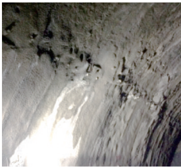
图6 雨季施工段初支湿润情况
